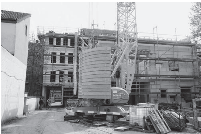
Baustelle für die neue Fünf-Gruppen-Kita am Westwall 200 im Gebäude der ehemaligen Volksschule.
